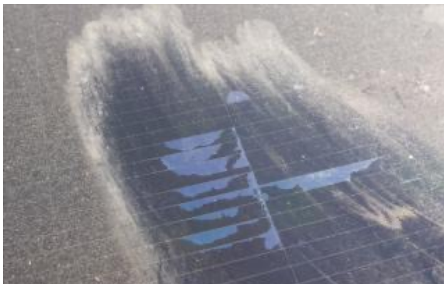
Abb. 5: Staubablagerung auf einem Photovoltaikmodul
